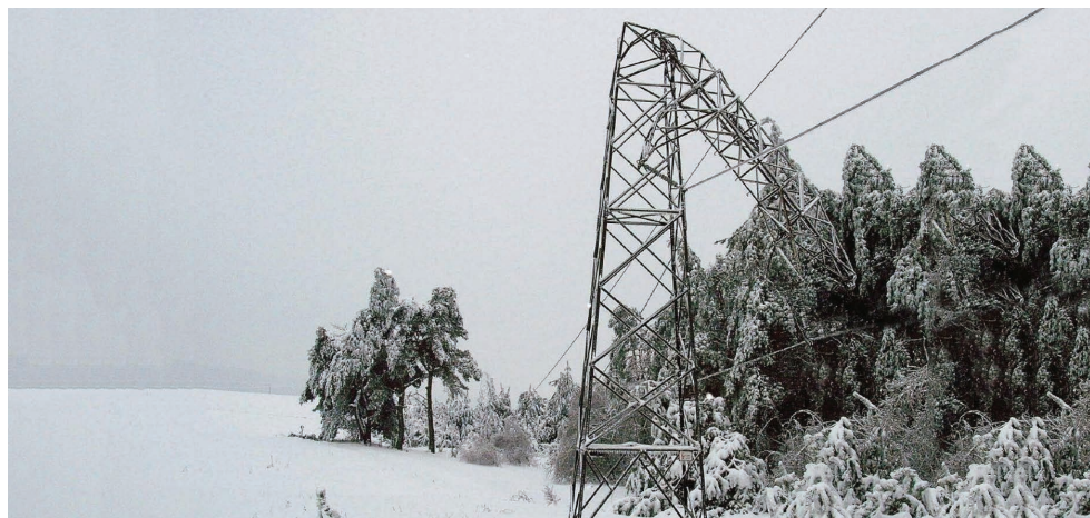
Rys.23. Słup energetyczny połamany na skutek silnych mrozów [19]
